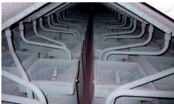
Dampftrommel Wasserrohrkessel 98 bar
