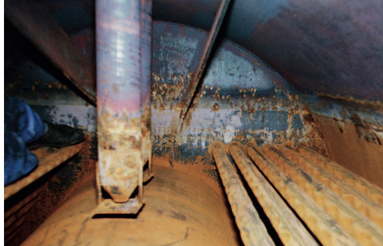
Großwasserraumkessel vor dem Einsatz von FINEAMIN®
